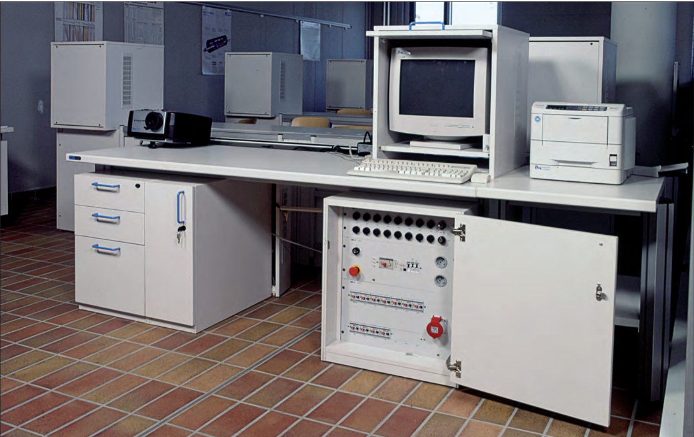
Beispiel eines Lehrerarbeitsplatzes mit Raumunterverteilung in 19“-Unterschrank
